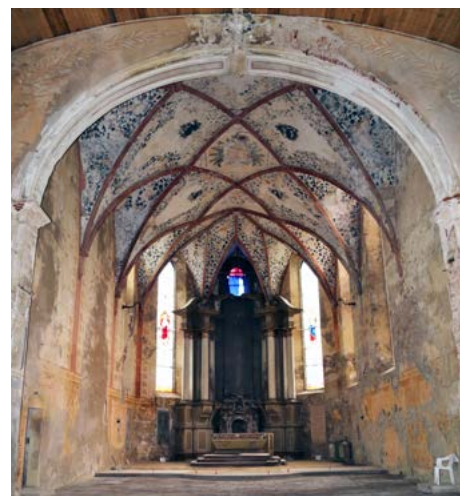
oltář před rekonstrukcí
